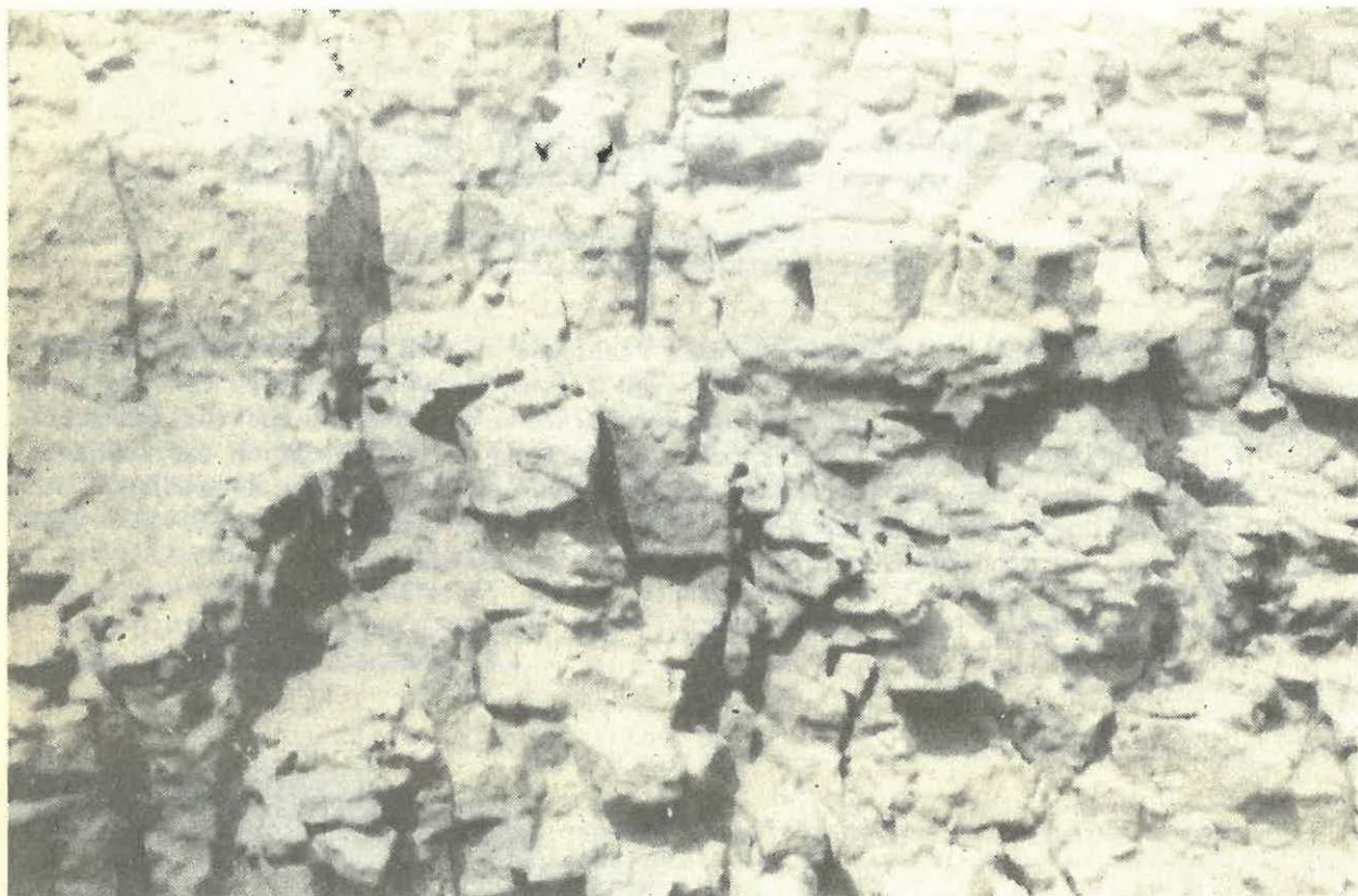
Obr. č. 2 Větráním silně narušená uhelná stěna před nanesením stabilizační vrstvy
