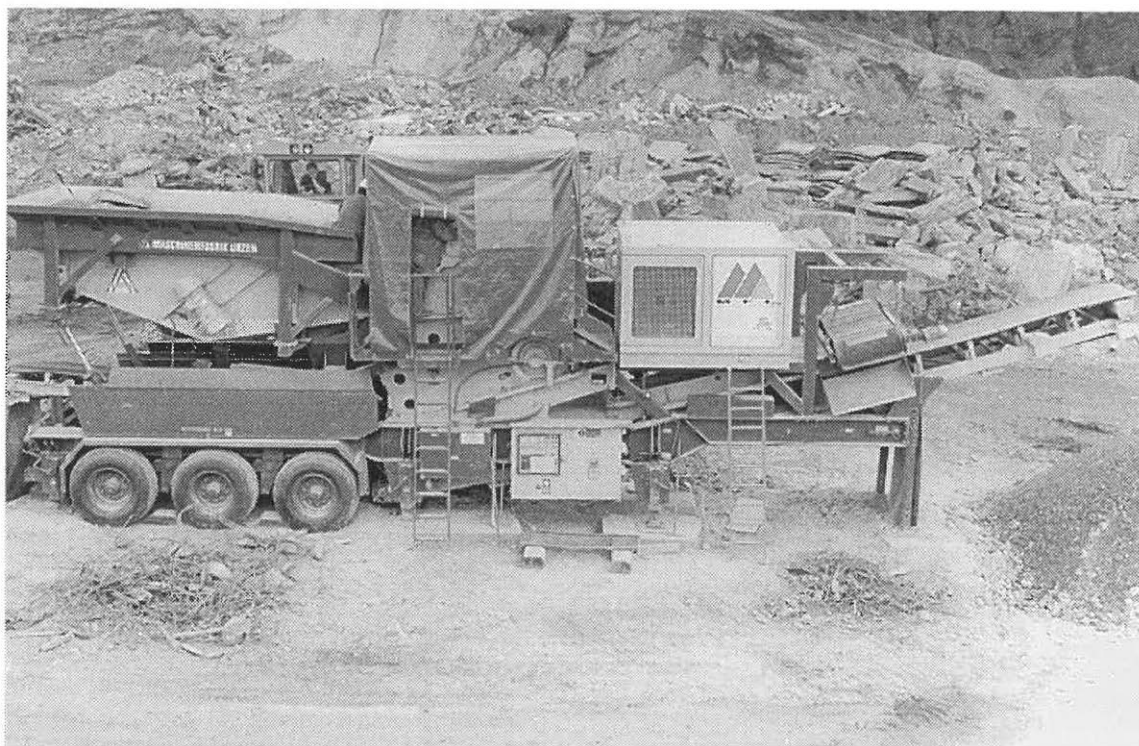
Obr. 1 Celkový pohled na mobilní drtící jednotku fy MFL - Maschinenfabrik Liezen
