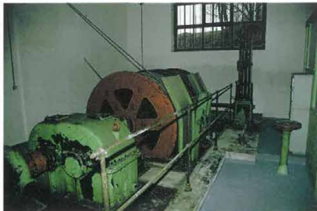
Elektrický těžní stroj Siemens z roku 1942 ve strojovně dolu Vilém (2000, foto P. Beran)
