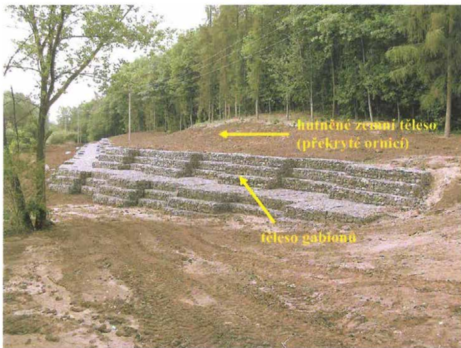
Pohled na opěrný stabilizační systém ve směru Most - Žatec
