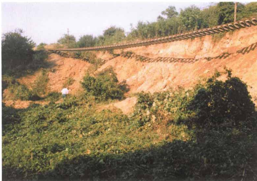
Obr. 4 Železniční těleso přimknuté ke břehu řeky Radbuzy u obce Hradec u Stodu bylo porušeno náhlým ztekucením jílovito-písčitého materiálu násypu (Foto M. Šedivý, srpen 2002)
