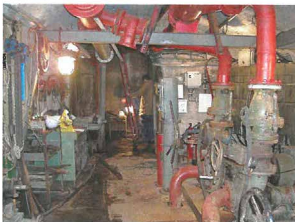
Foto 1: Původní vybavení ČS, vpravo dvě z čerpadel. Pod plechovým překrytem, kterým procházejí sací potrubí, je puklina, z níž byla čerpána voda
