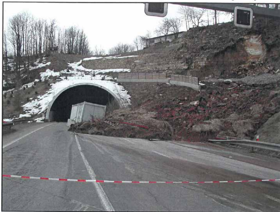
Obr.1 - Pohled na zasypanou část východního portálu tunelu Hřebeč - 15.00 hod. (1.den)
