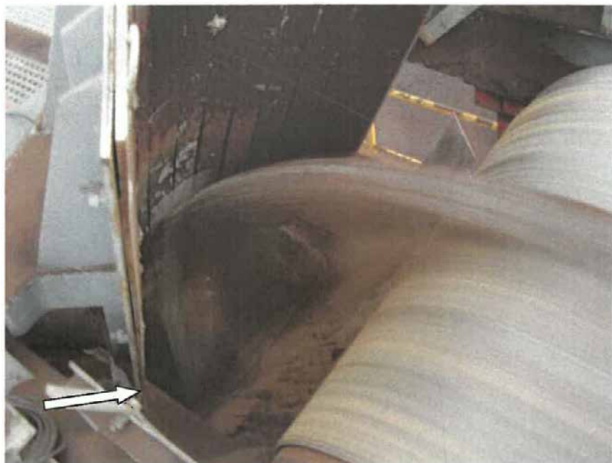
Obr.3 - Násypka shazovacího vozu s klapkou na hlavní pás (uhlí)
