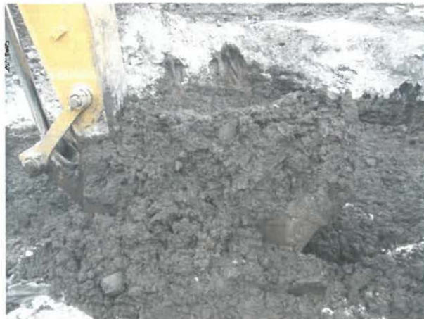
Obr. 4 - Stabilizovaný retenční kal v jímce
