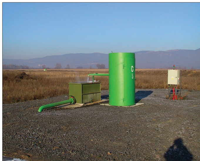
Obr. 8: Typický čerpací odvodňovací vrt v předpolí lomu Bílina. Foto: K. Mach.
