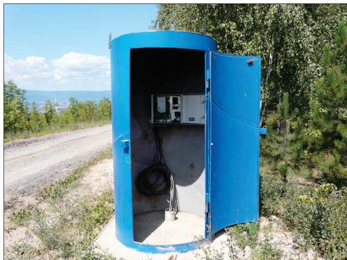
Obr. 4: Uzamykatelný ocelový objekt vrtu RS 137.
