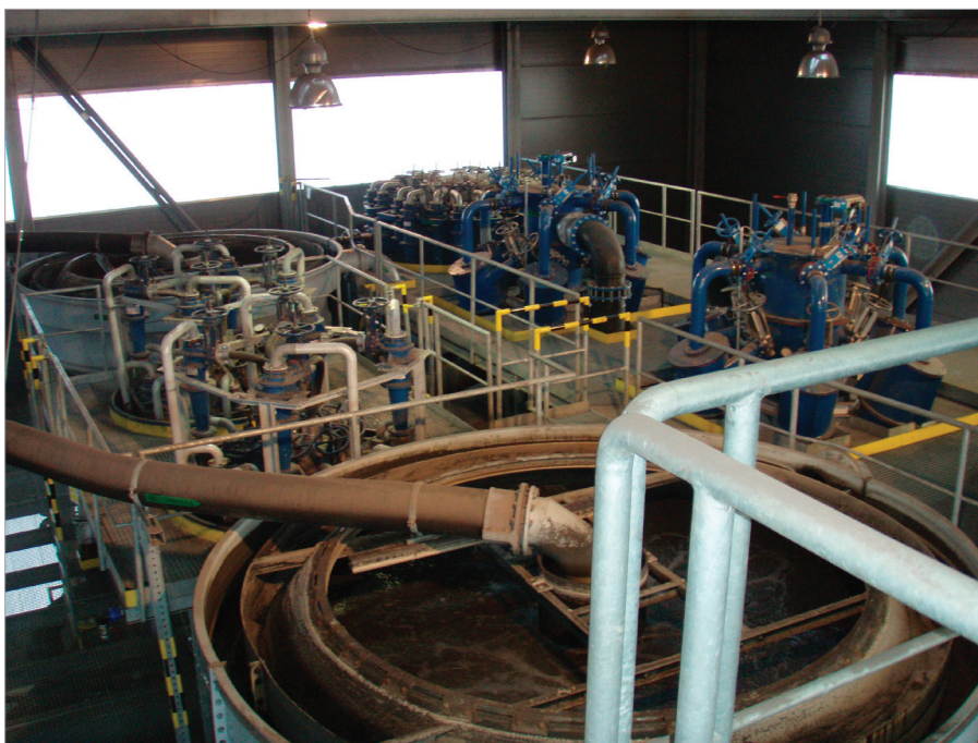
Obr. 8: Technologie hydrocyklonů na patře +24,610.
