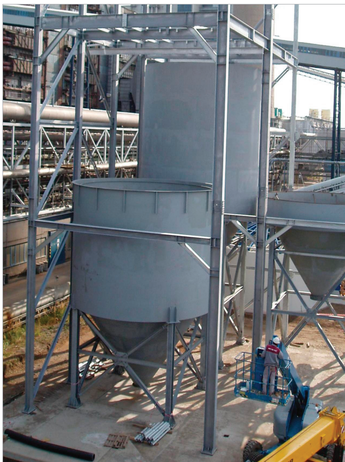
Obr. 4: Vstupní přijímací nádrž.
