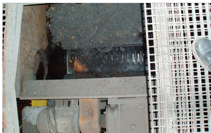
Obr. 22: Pohled do drtiče při provozu.
