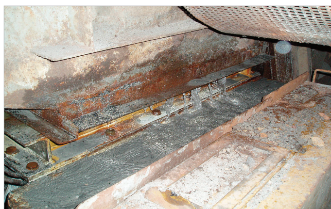
Obr. 26: Unikající směs ze skříně vynášече.
