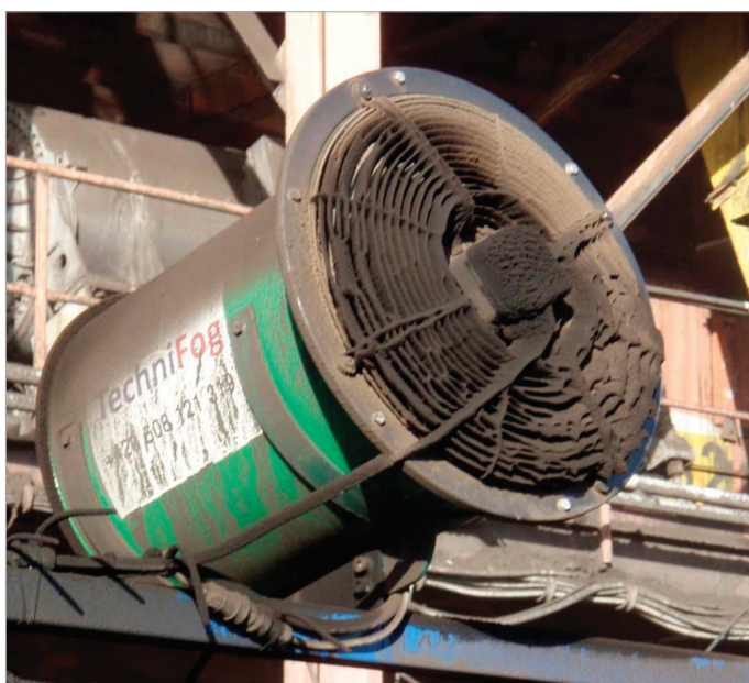
Obr. 9: Detailní pohled na znečištěný sacího ventilátoru.
