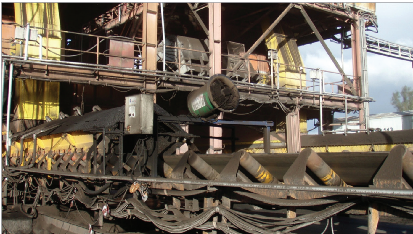
Obr. 8: Ilustrace těžkých provozních podmínek a vlivu dalších zdrojů prachu.
