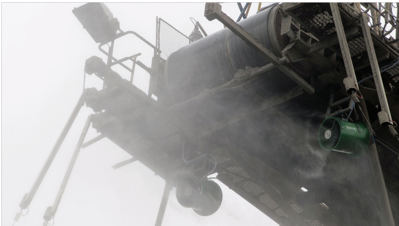
Obr. 10: Detailní pohled na znečištění sacího ventilátoru.
