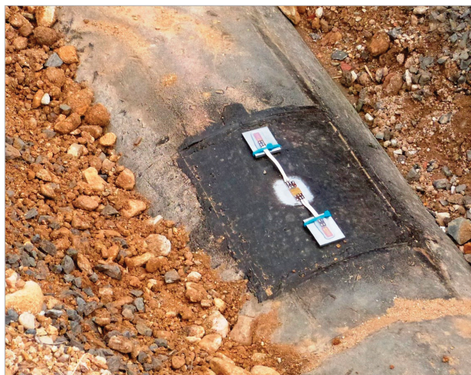
Obr. 5: Tenzometry zaznamenávající změny vnitřního napětí v chráničkách.
