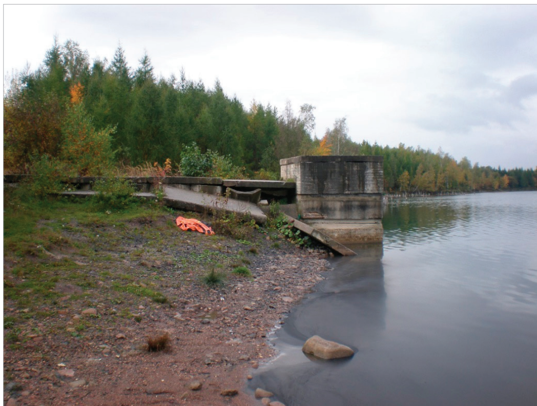
Obr. 2: Čerpací stanice v jihovýchodním cípu jezera, sloužící jako záložní zdroj požární vody pro AGC Flat Glass Czech a.s., závod Barevka.
