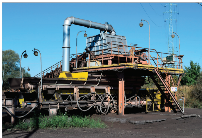
Obr. 10: Odprášení přesypu PD 161→PD 162.
