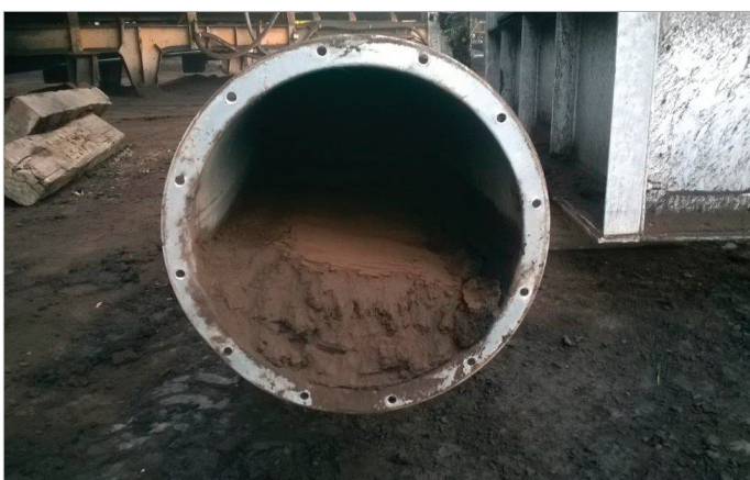
Obr. 8: Ucpané potrubí na přesypu PD 156→PD 157 na straně sání.
