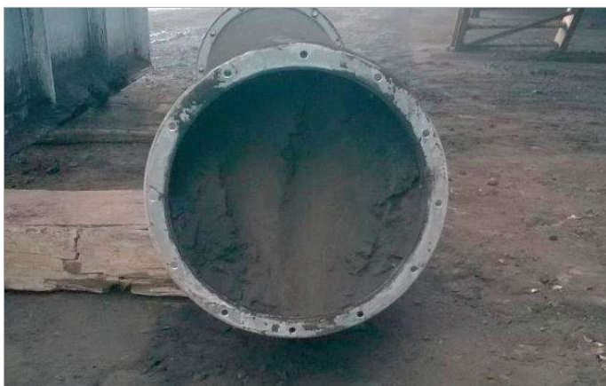
Obr. 7: Ucpané potrubí na přesypu PD 156→PD 157 na straně výduchu.
