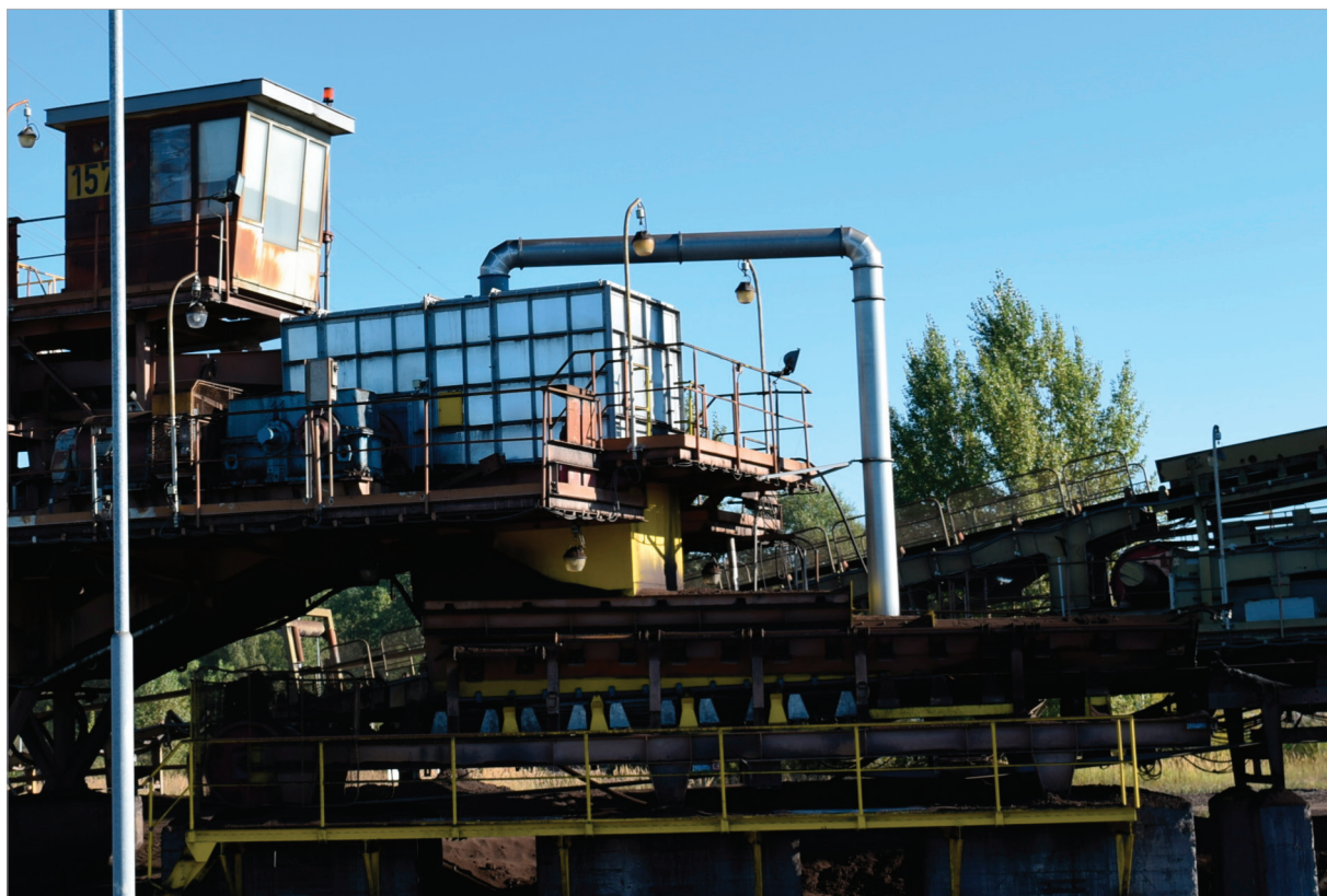
Obr. 5: Odprášení přesypu PD 157→PD 158.
