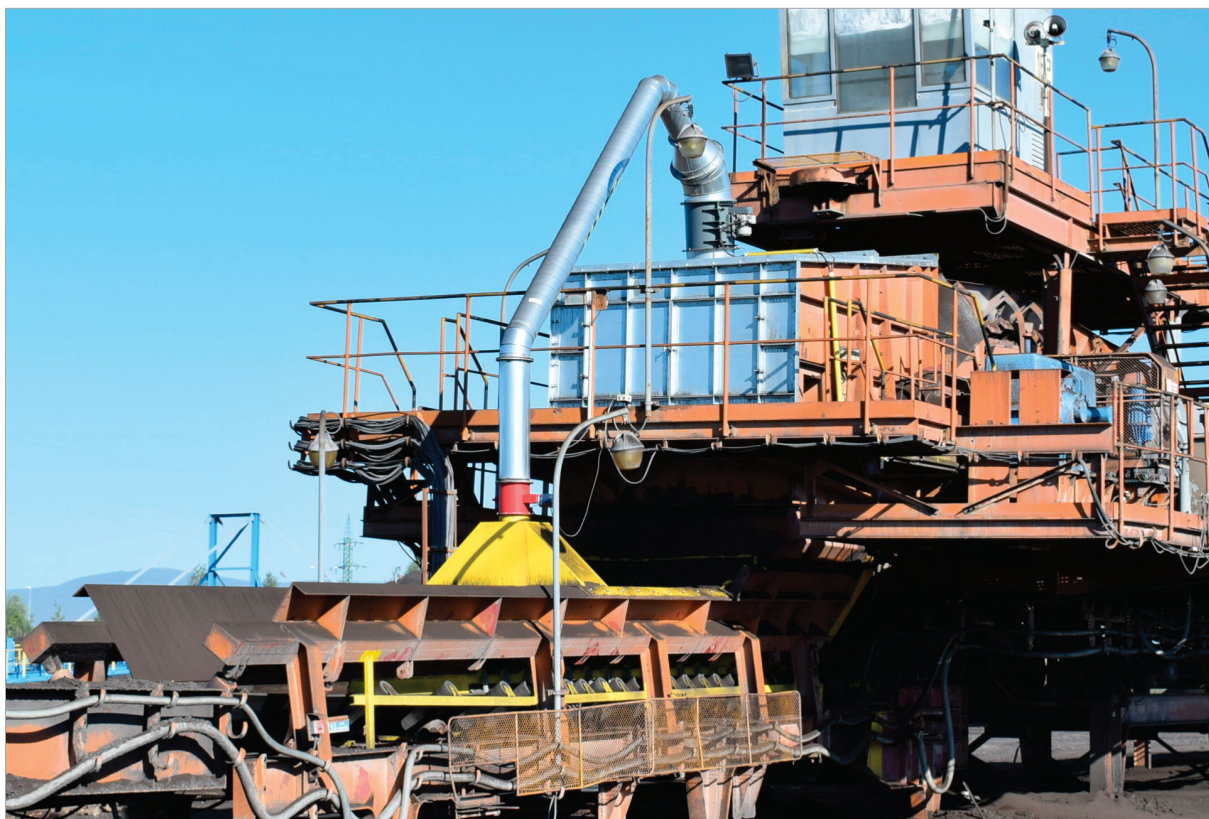
Obr. 12: Odprášení přesypu PD 162→PD 163.
