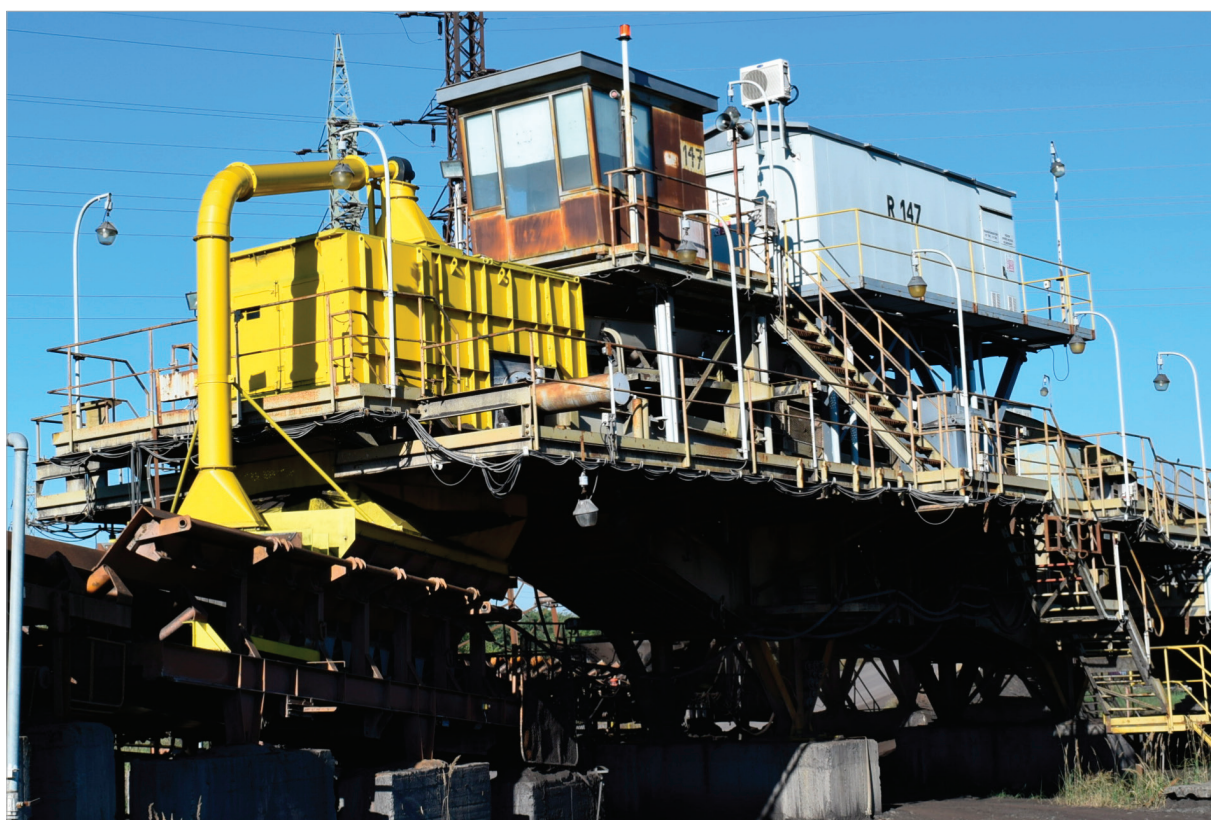
Obr. 4: Odprášení přesypu PD 147→PD 148.
