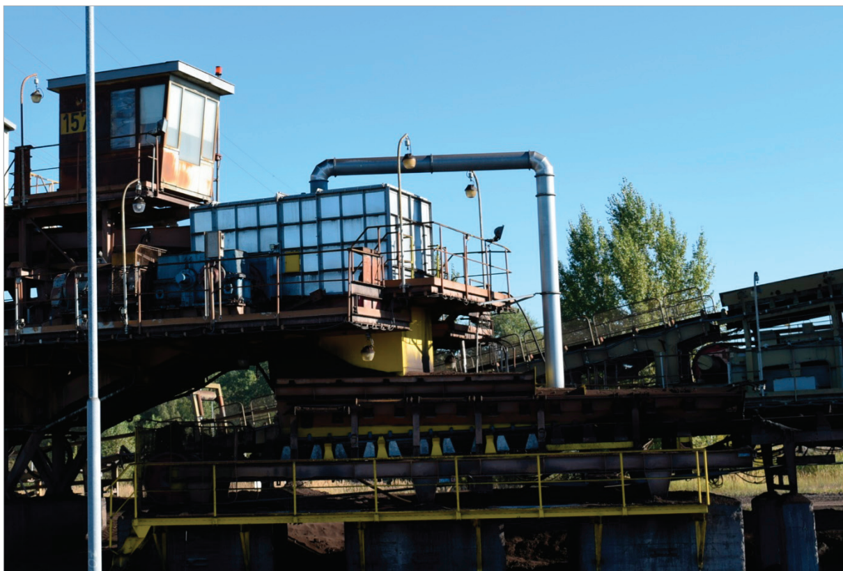
Obr. 2: Odprášení přesypu PD 157→PD 158.
