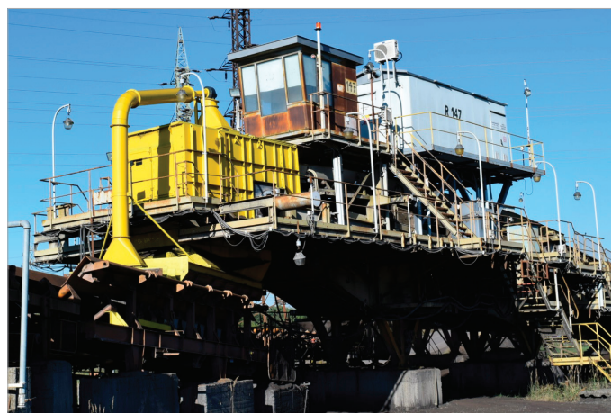
Obr. 1: Odprášení přesypu PD 147→PD 148.
