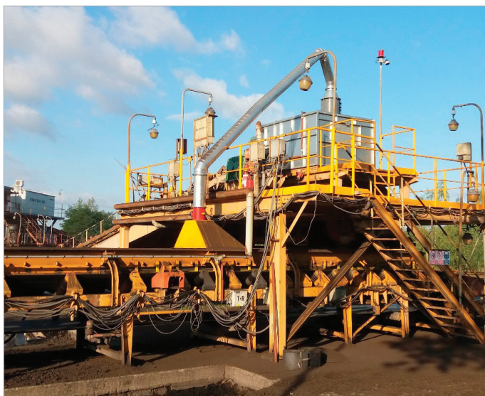
Obr. 8: Odprášení Přesypu PD164→PD165.
