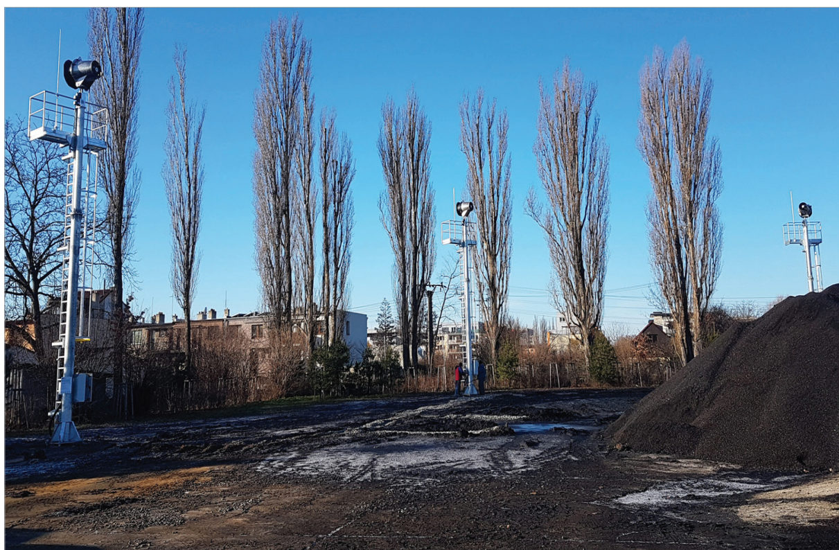
Obr. 15: Mlžící stěna na Teplárně Uherské Hradiště.
