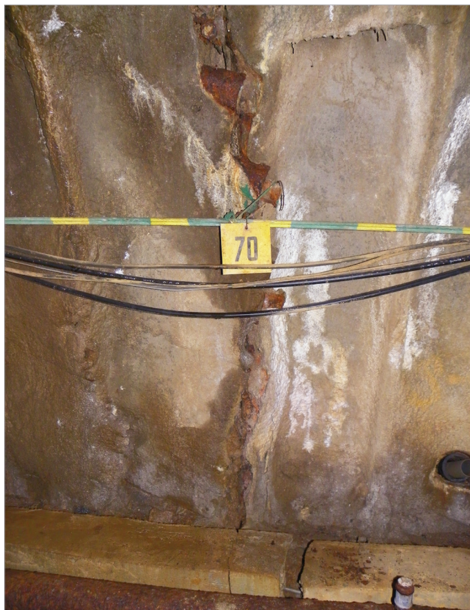
Obr. 3: Tahová trhlina ve štolě Jezeří porušující výztuž štolý po celém jejím obvodu (Foto: J. Burda, 2012).
