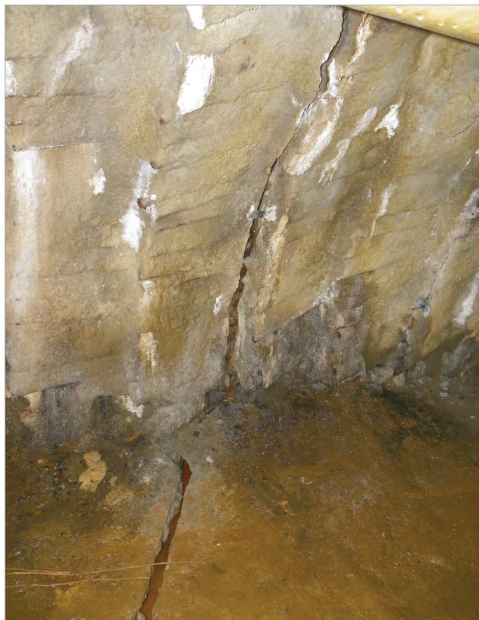
Obr. 2: Extenze štolý Jezeří se ve staničení 61,5-85,6 m projevila vznikem tahové trhliny (Foto: J. Burda, 2012).
