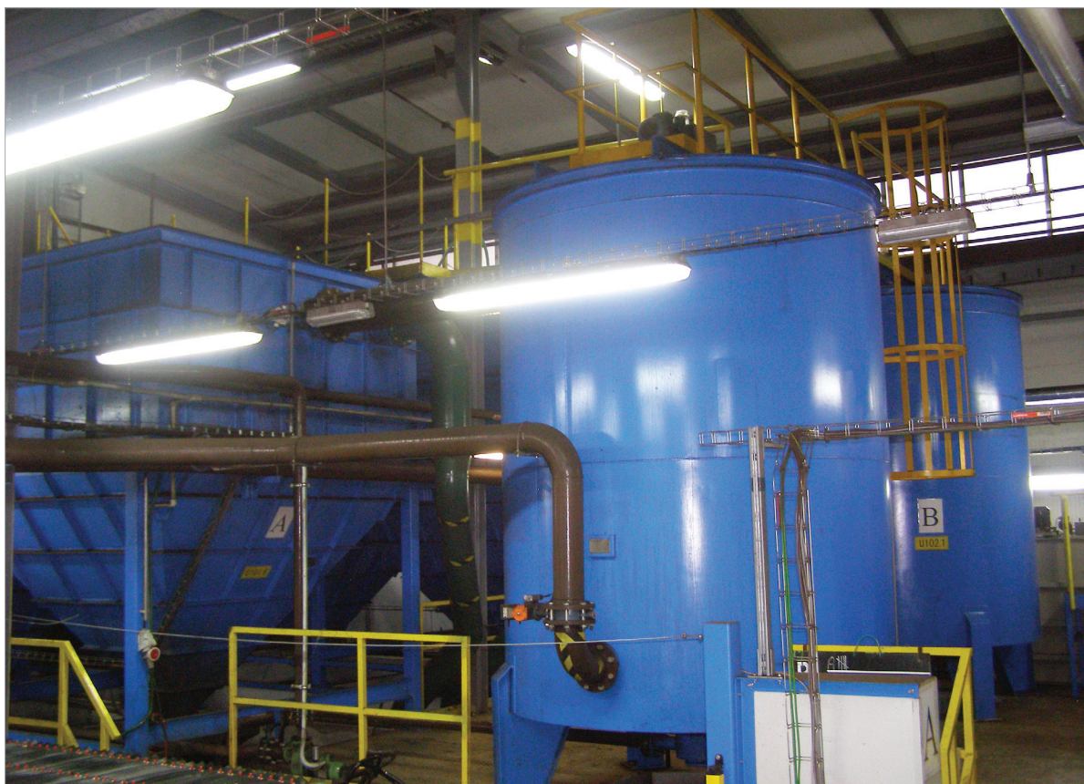
Obr. 1: Flokulační komory, lamelové usazovací nádrže.
