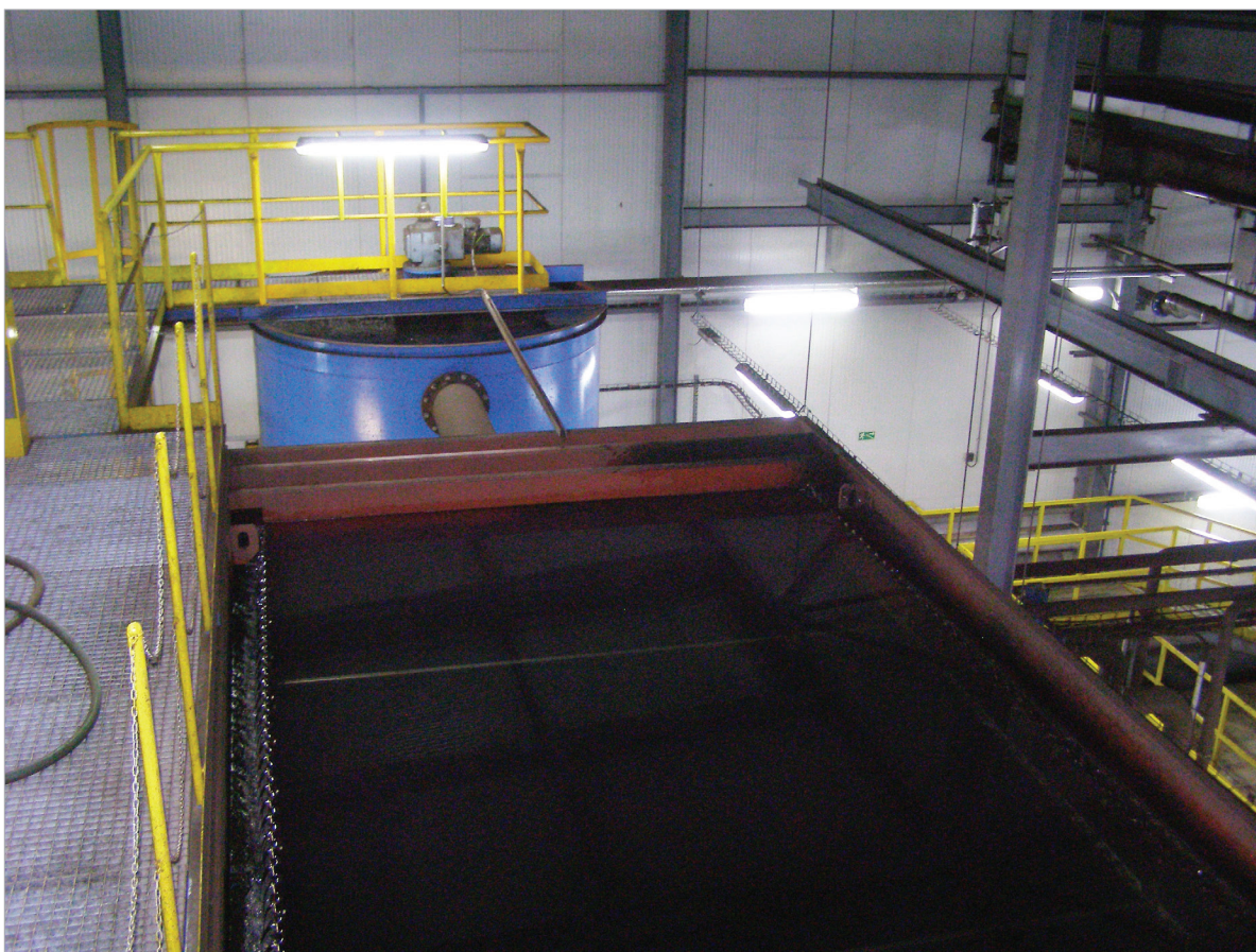
Obr. 3: Přepad čisté vody z lamelové usazovací nádrže.
