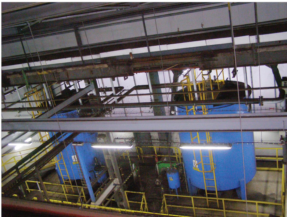
Obr. 5: Zahušťovací nádrže kalů.
