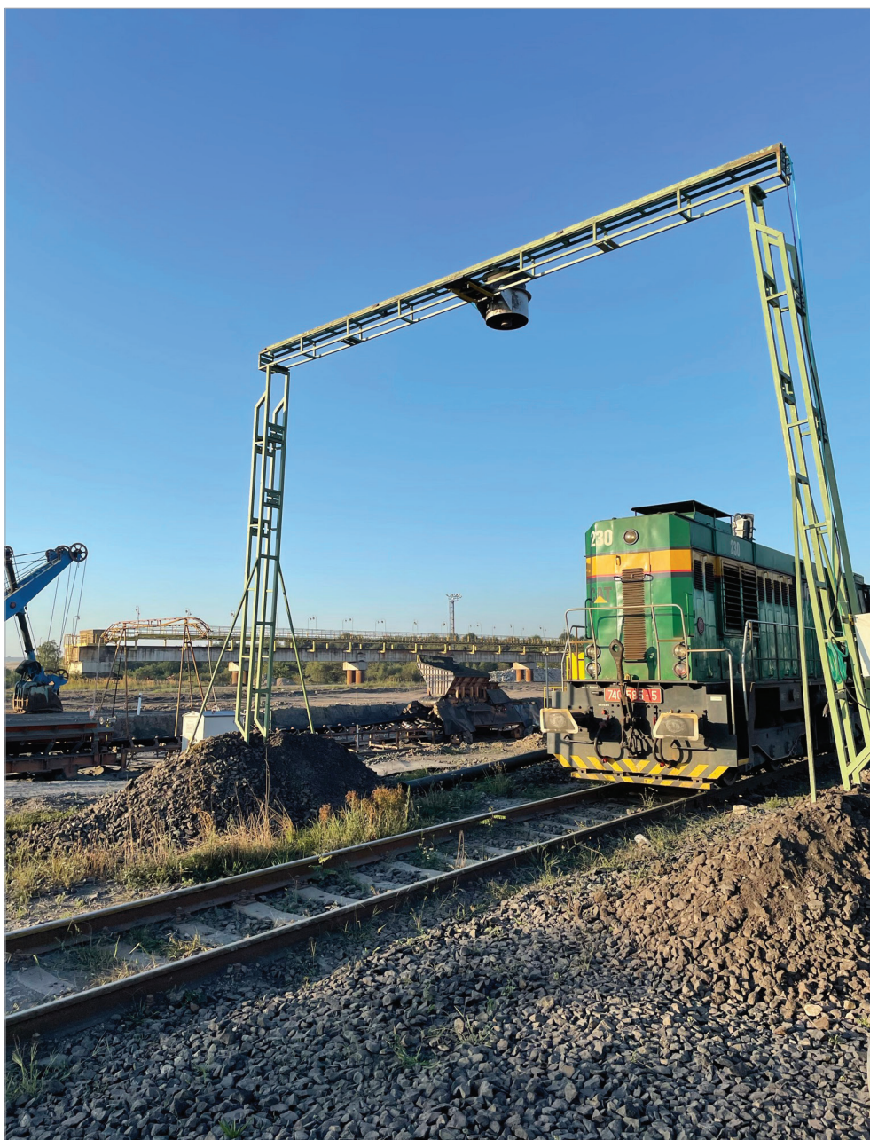
Obr. 1: Kabelová lávka s RMJ 500 N1 na překladišti VEP Příkupy. (Foto: archiv autora).
