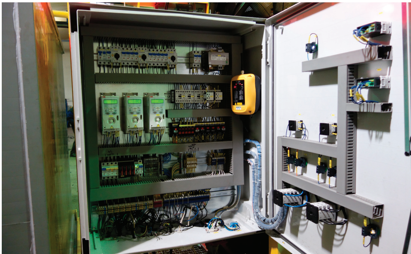
Obr. 3: Hlavní rozváděč R 1. (Foto: archiv autorů)
