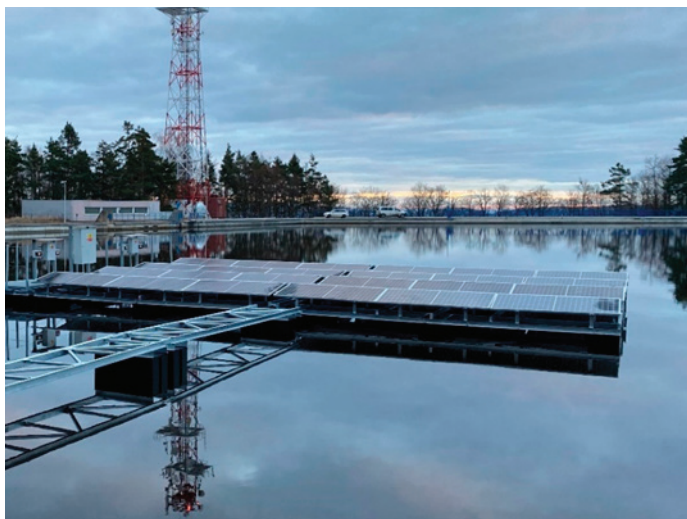
Obr. 10: Zařízení při maximální pracovní hladině přečerpávací elektrárny. (Foto: archiv autorů)
