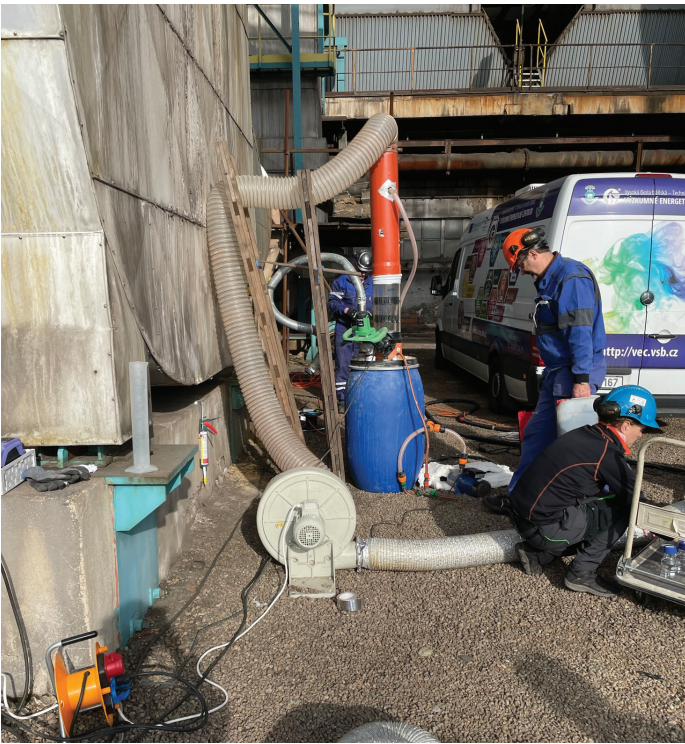
Obr. 1: Testování jednotky v provozu.
